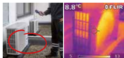
Schnelle und mühelose Überprüfung einer Klimaanlage.
