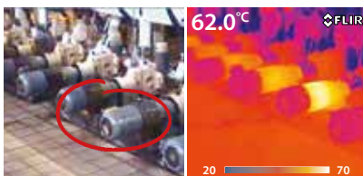
Mechanische Überprüfung eines Elektromotors.
